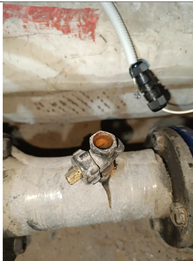
Фото 20 – Шаровой кран в нерабочем состоянии
