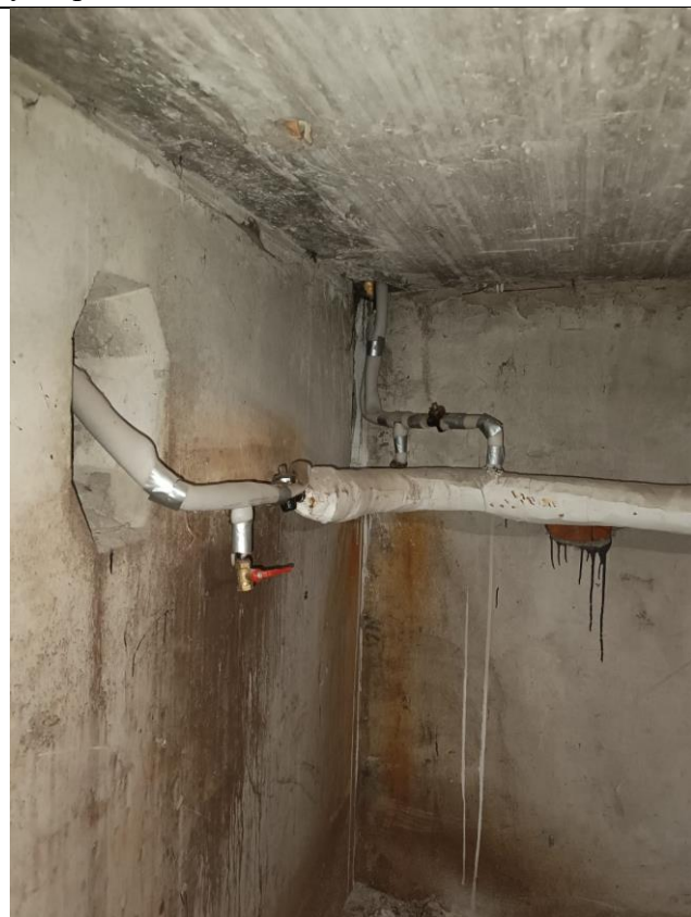
Фото 31 – Запорно-регулирующая арматура находится в неработоспособном состоянии. Тепловая изоляция технически и морально
