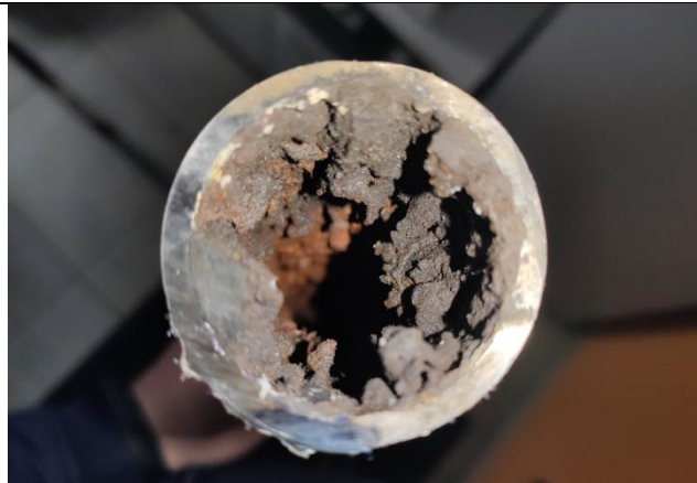
Фото 27– Предоставлен демонтированный участок трубопровода из системы ГВС. На внутренней поверхности наблюдаются накипно-коррозионные отложения и повреждения коррозией стенок труб
