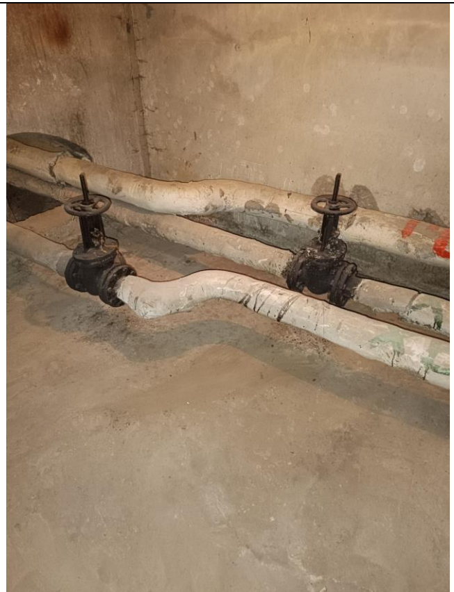
Фото 26 – Запорно-регулирующая арматура находится в ограниченно-работоспособном состоянии не обеспечивать полное закрытие подачи воды
