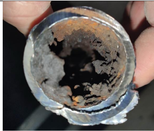
Фото 28 – Предоставлен демонтированный участок трубопровода из системы ГВС. На внутренней поверхности наблюдаются накипно-коррозионные отложения и повреждения коррозией стенок труб
