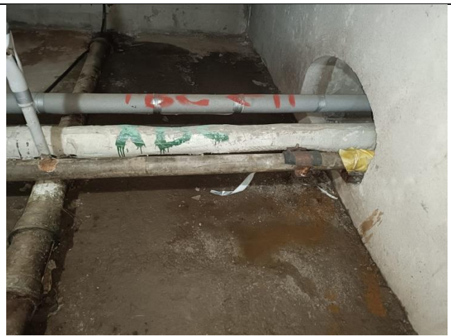
Фото 14 – Теплоизоляционное покрытие трубопроводов морально и технически устарело
