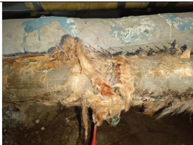
Фото 9 – Наличие течи в сварном соединении
