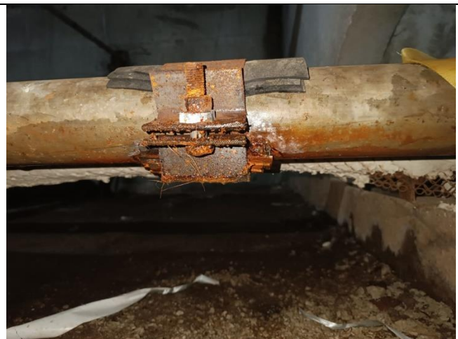
Фото 16 – Места значительных коррозионных разрушений стальных стенок трубопроводов ГВС, где установлены ремонтные хомуты
