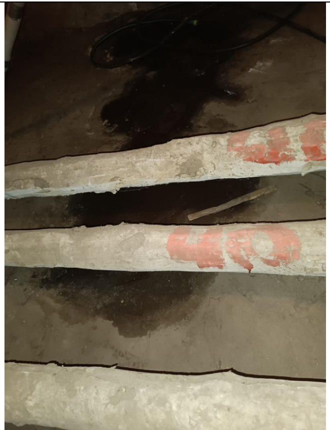
Фото 30 – Теплоизоляционное покрытие трубопроводов морально и технически устарело
