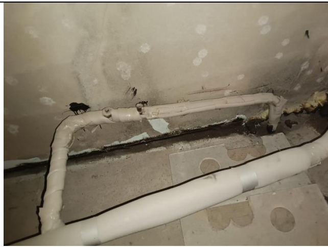
Фото 37 – Запорно-регулирующая арматура находится в неработоспособном состоянии. Тепловая изоляция технически и морально устарела
