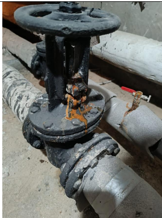
Фото 18 – Запорно-регулирующая арматура находится в ограниченно-работоспособном состоянии не обеспечивать полное закрытие подачи воды. Имеет места протечек из-за нарушения герметичности
