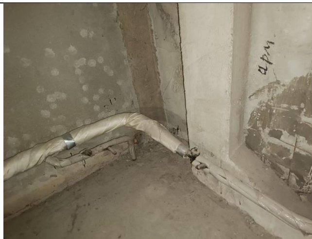
Фото 39 – Запорно-регулирующая арматура находится в неработоспособном состоянии. Тепловая изоляция технически и морально устарела
