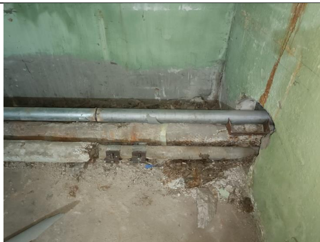
Фото 13 – Места значительных коррозионных разрушений стальных стенок трубопроводов ГВС, где установлены ремонтные хомуты
