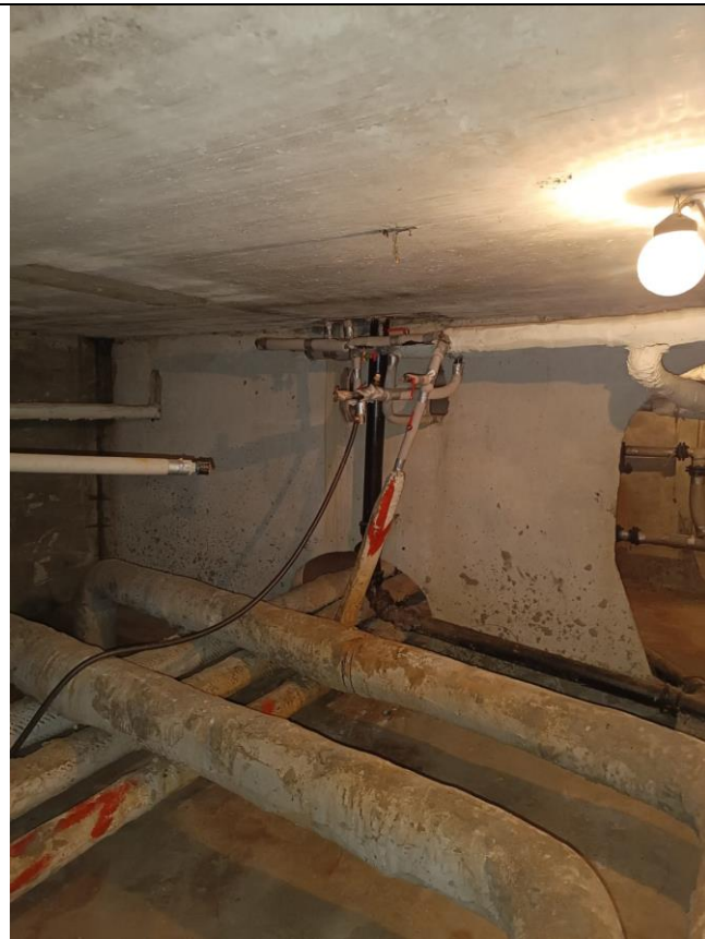
Фото 29 – Теплоизоляционное покрытие трубопроводов морально и технически устарело
