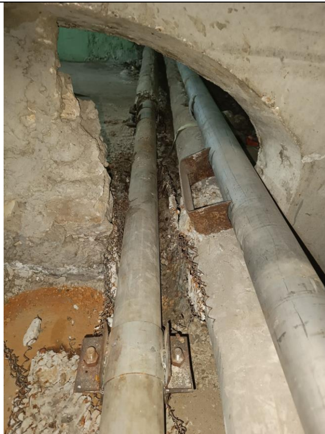
Фото 25 – Фото 2 – Места значительных коррозионных разрушений стальных стенок трубопроводов ГВС, где установлены ремонтные хомуты. Отсутствует тепловая изоляция
