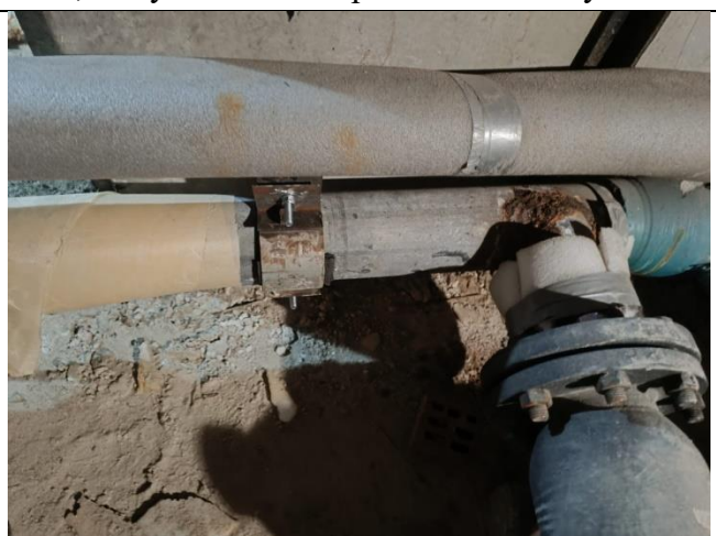
Фото 4 – Места значительных коррозионных разрушений стальных стенок трубопроводов ГВС, где установлены ремонтные хомуты
