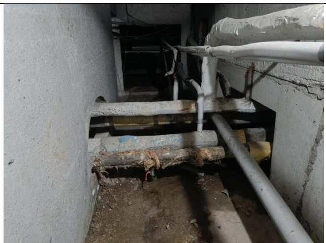
Фото 5 – Теплоизоляционное покрытие трубопроводов морально и технически устарело
