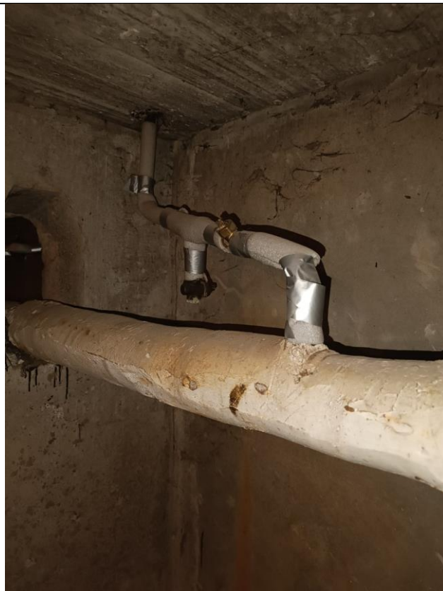
Фото 33 – Запорно-регулирующая арматура находится в неработоспособном состоянии. Тепловая изоляция технически и морально устарела
