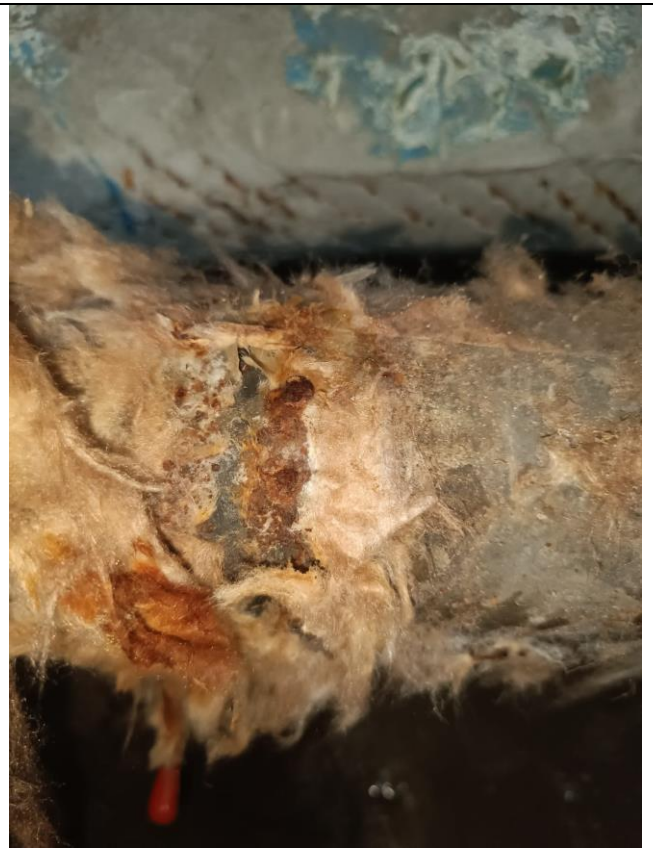
Фото 8 – Наличие течи в сварном соединении
