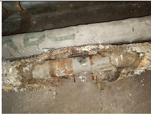
Фото 11 – Места значительных коррозионных разрушений стальных стенок трубопроводов ГВС, где установлены ремонтные хомуты
