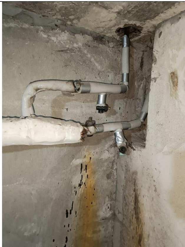
Фото 34 – Запорно-регулирующая арматура находится в неработоспособном состоянии. Тепловая изоляция технически и морально устарела
