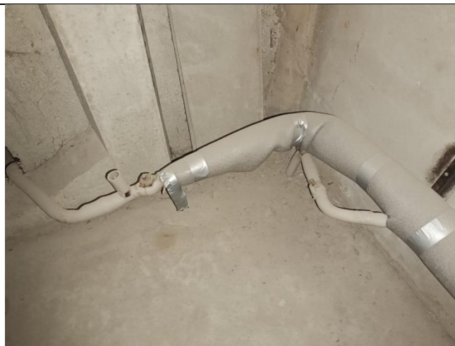
Фото 35 – Запорно-регулирующая арматура находится в неработоспособном состоянии. Тепловая изоляция технически и морально устарела
