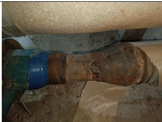
Фото 1 – Места заварок трубопроводов ГВС. Отсутствует теплоизоляционное покрытие
