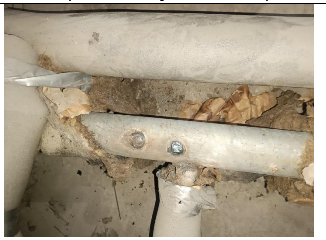
Фото 6 – Места заварок трубопроводов ГВС. Отсутствует теплоизоляционное покрытие
