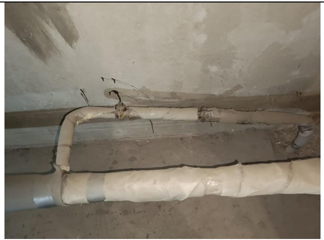
Фото 38 – Запорно-регулирующая арматура находится в неработоспособном состоянии. Тепловая изоляция технически и морально устарела
