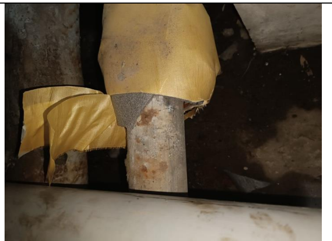
Фото 10 – Коррозия наружной поверхности трубопроводов
