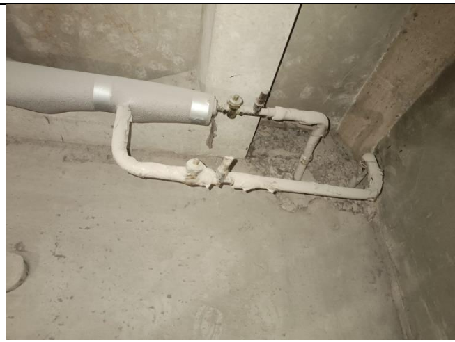
Фото 40 – Запорно-регулирующая арматура находится в неработоспособном состоянии. Тепловая изоляция технически и морально устарела
