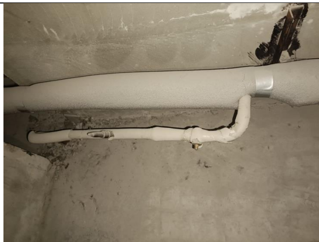
Фото 36 – Запорно-регулирующая арматура находится в неработоспособном состоянии. Тепловая изоляция технически и морально устарела
