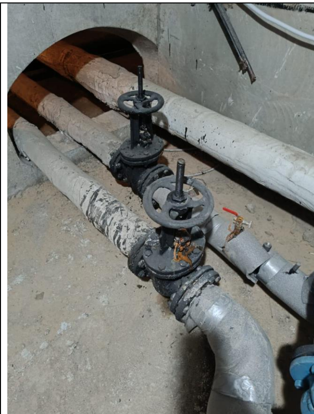
Фото 17 – Запорно-регулирующая арматура находится в ограниченно-работоспособном состоянии не обеспечивать полное закрытие подачи воды. Имеет места протечек из-за нарушения герметичности
