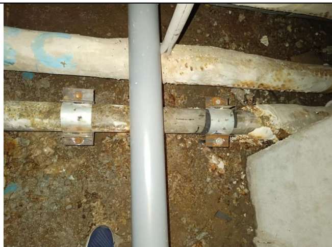
Фото 2 – Места значительных коррозионных разрушений стальных стенок трубопроводов ГВС, где установлены ремонтные хомуты
