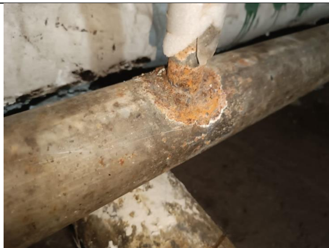
Фото 15 – Коррозия наружной поверхности трубопроводов
