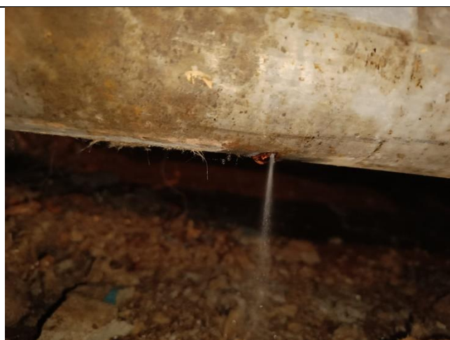
Фото 3 – При проведении обследования выявлены места течи на трубопроводах ГВС
