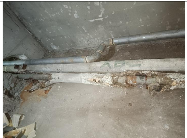
Фото 12 – Места значительных коррозионных разрушений стальных стенок трубопроводов ГВС, где установлены ремонтные хомуты
